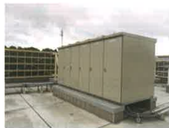
▲屋上に設置された発電装置
